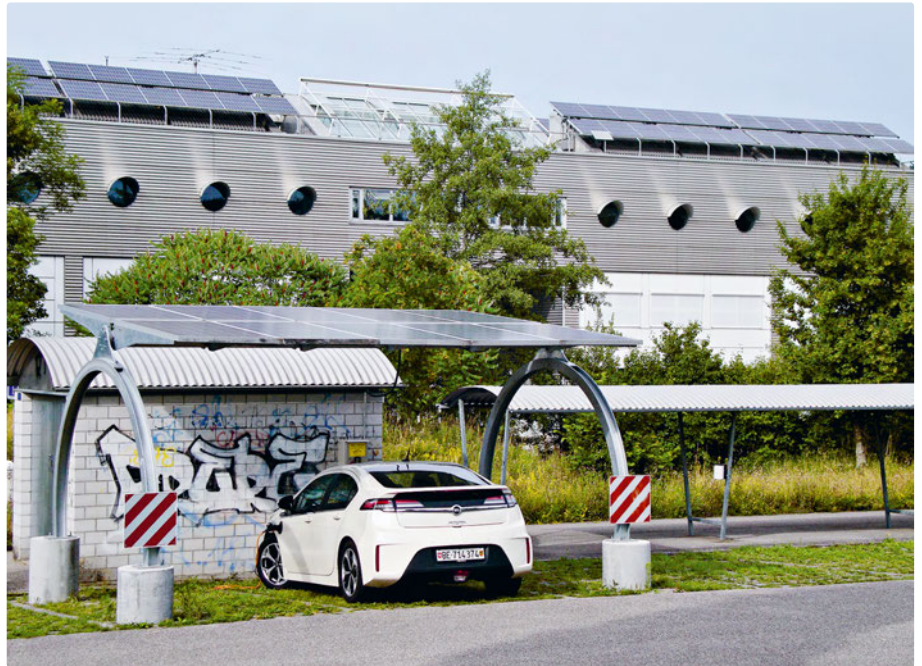
Abb. 1: Solarcarport für Elektroautos der BFH-TI in Burgdorf.
