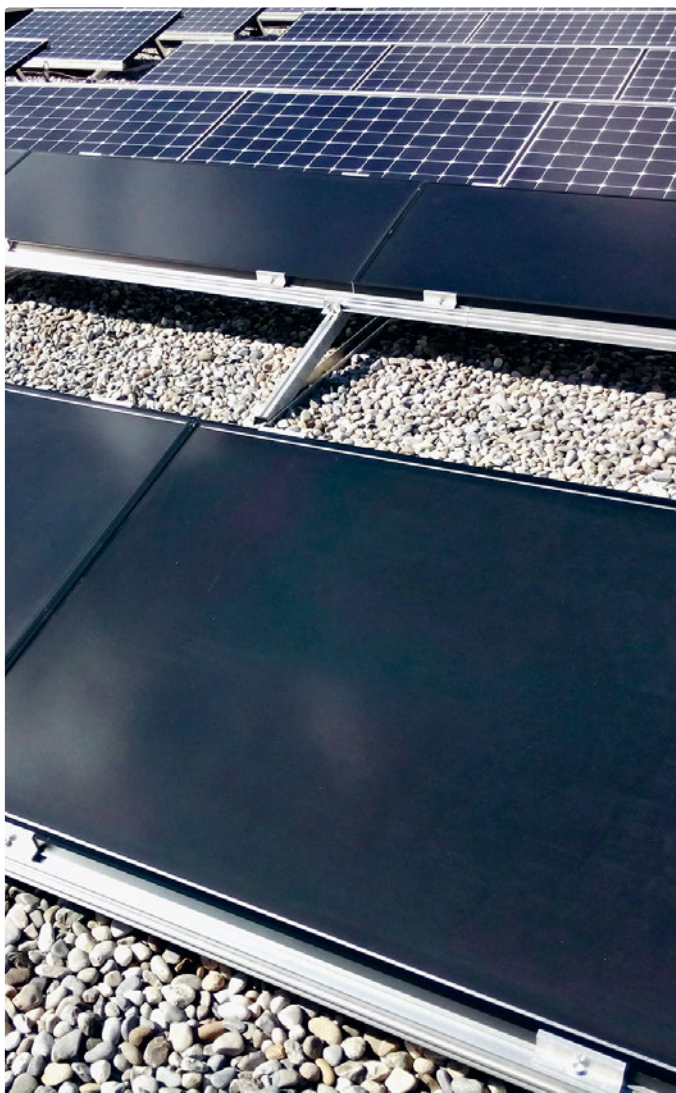
Fig. 1: Installation de test de différentes technologies solaires
